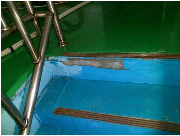
손상내용 1지 계단 파손 손상원인 공용열화
