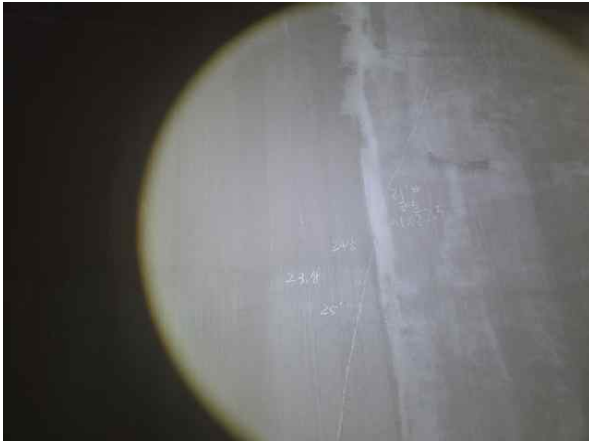
손상내용 유입밸브실 벽체 균열 손상원인 건조수축
