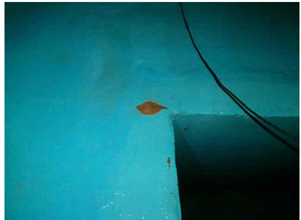
손상내용 1지 바닥슬래브 도장박리 손상원인 공용열화
