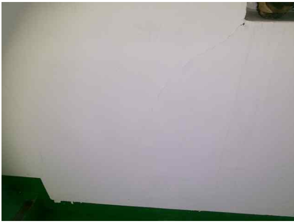
손상내용 검수실 벽체 균열 손상원인 건조수축
