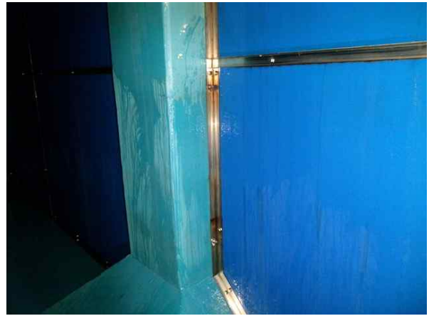
손상내용 1지 도류벽 녹 손상원인 공용열화
