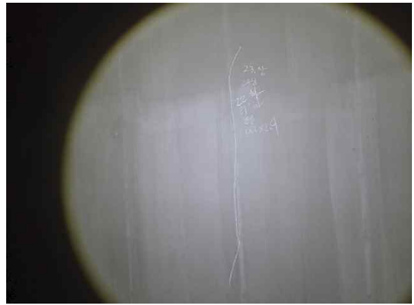
손상내용 유입밸브실 벽체 균열 손상원인 건조수축
