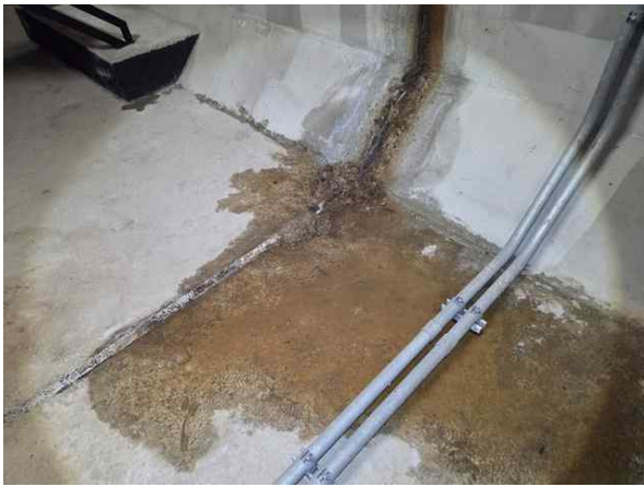
손상내용 유입밸브실 바닥슬래브 누수 손상원인 공용열화
