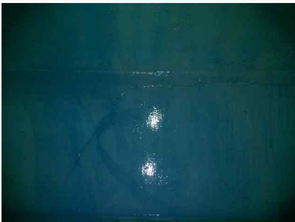
손상내용 1지 벽체 균열 손상원인 건조수축
