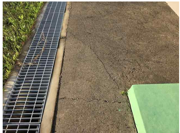
손상내용 검수실 외부바닥 균열 손상원인 건조수축
