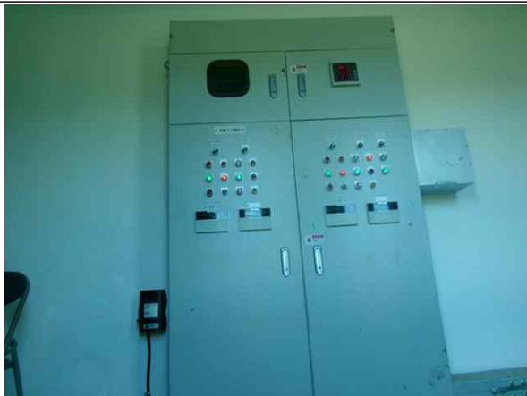
전기실 내부 전경
