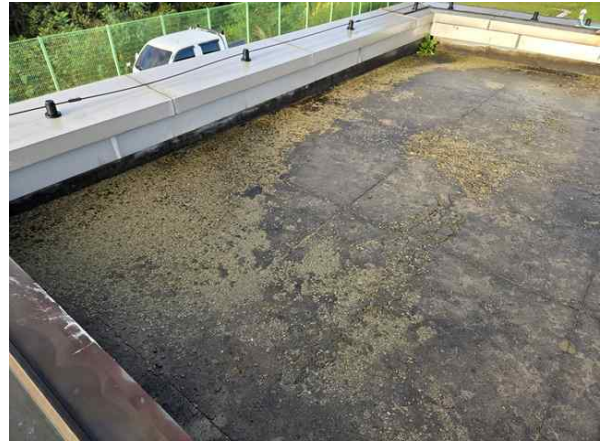
손상내용 검수실 옥상층 박리 손상원인 공용열화, 시공미흡
