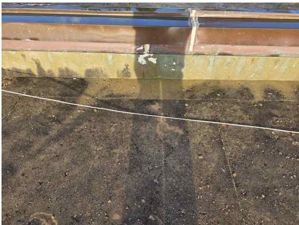
손상내용 검수실 옥상층 균열 손상원인 건조수축
