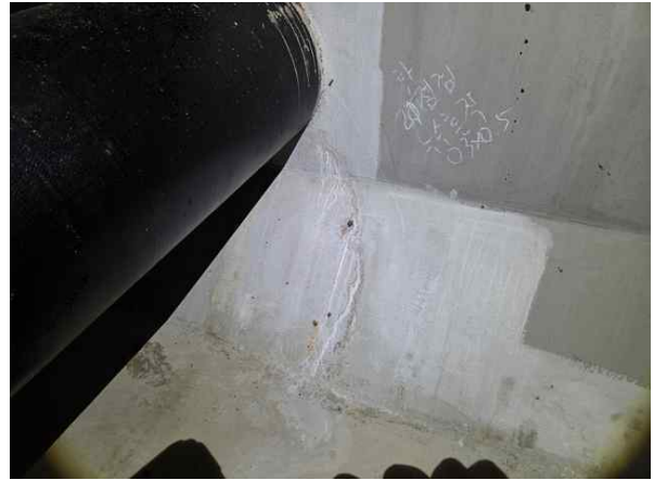
손상내용 유입밸브실 균열부 백태 손상원인 건조수축 + 습윤침투
