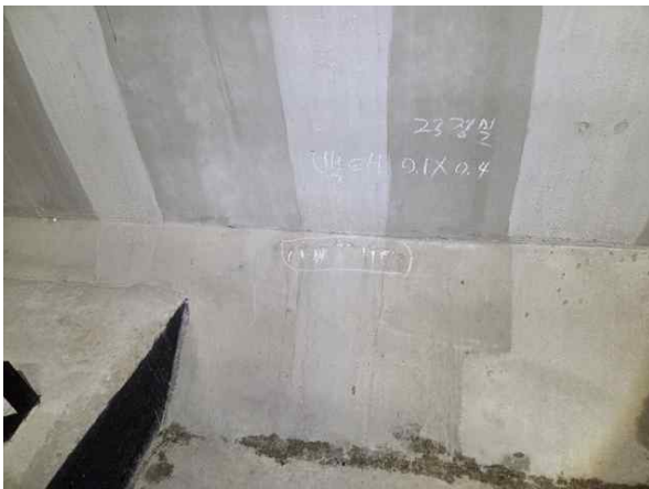
손상내용 유입밸브실 벽체 백태 손상원인 습윤침투
