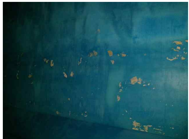
손상내용 1지 벽체 도장박리 손상원인 공용열화
