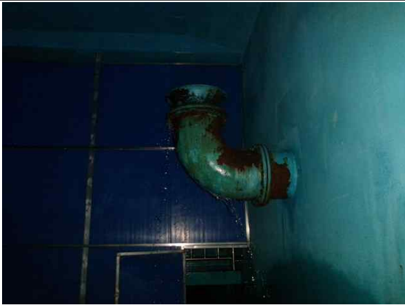
기계설비(1지 유입 배관)
